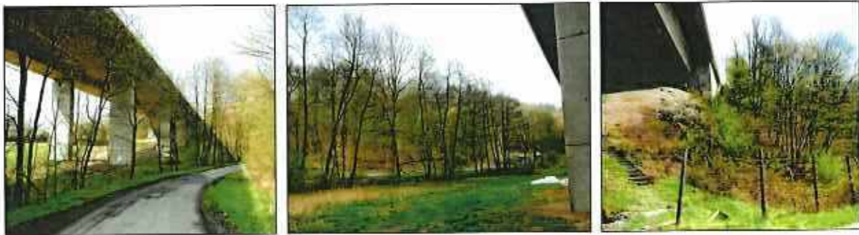
Abb. 4 Bäume im Bereich der Kreuzbach Talbrücke wurden auf Fledermausquartiere untersucht (Fotos: V. Bellen)
