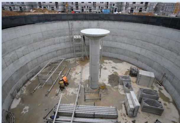
Ansicht in das Innere des Eisspeichers
