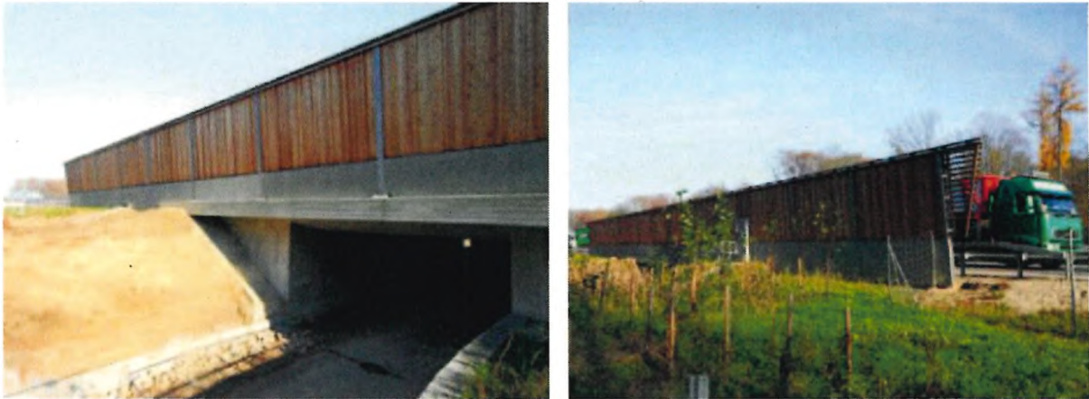
Abbildung 4: Beispiel für Irritationsschutzwände (BAB A 5 bei Offenburg). Die Höhe (ca. 3 m) lässt eine Annahme durch die meisten strukturgebunden fliegenden Fledermausarten erwarten. (Quelle: BRINKMANN et al. 2012).
